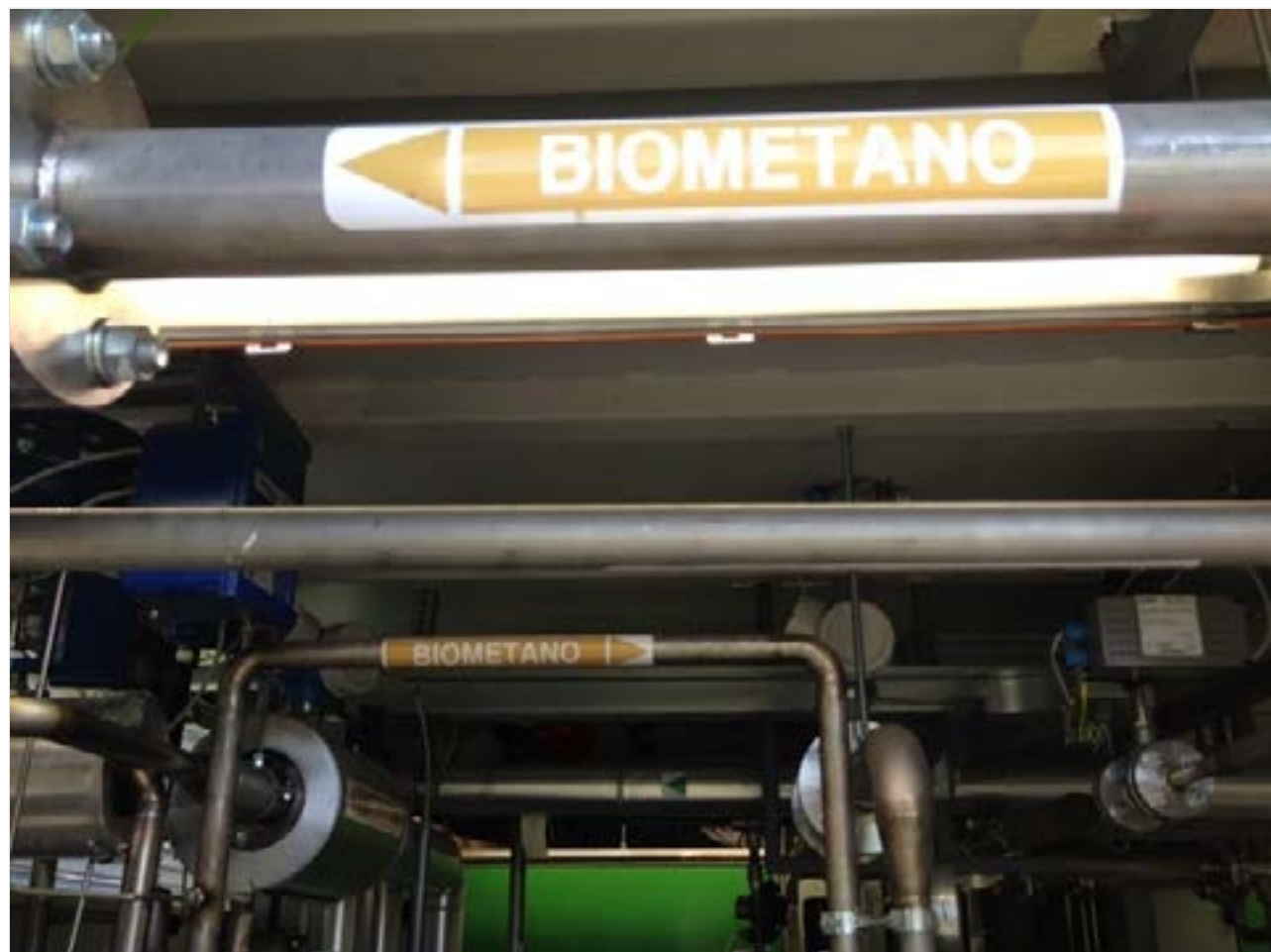
Il sistema di upgrading a membrane di Acea Pinerolese
